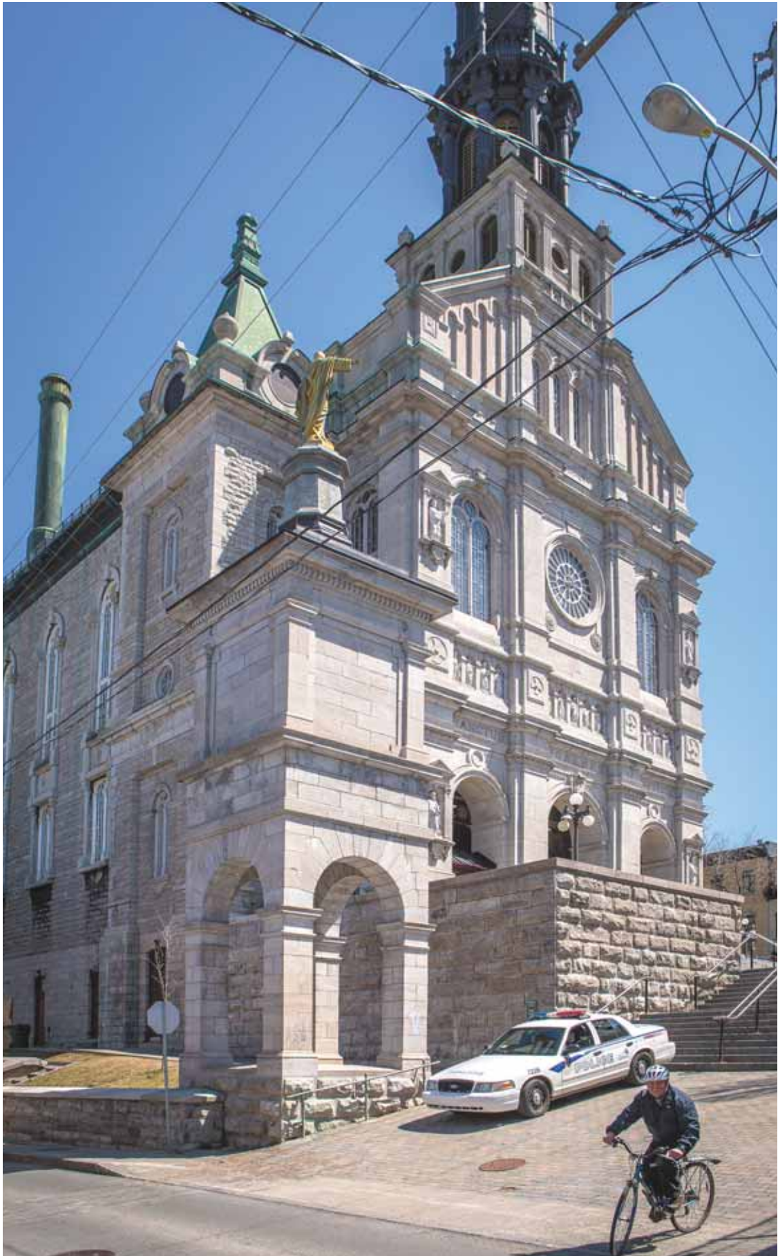
L'église Saint-Jean-Baptiste de Québec nécessite des travaux de 10 millions de dollars. L'entretien de base du bâtiment coûte à lui seul 150 000 $ par année.
